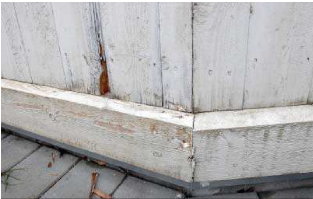
Norra fasaden. "Hildas hus ruttnar faktiskt inte. Det är fasadpanelen på norra sidan som det är problem med.", skriver insändarskribenten. Foto: STEFAN ÖHBERG
