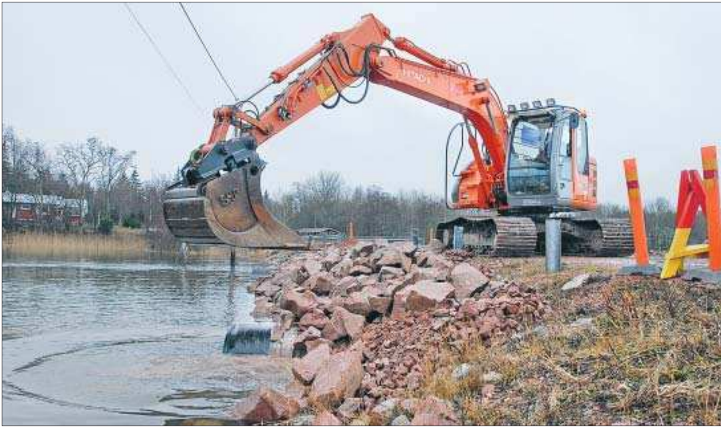
Renoverad vägbank. Vattengenomströmningen påverkas inte men vägen blir stabilare, då vägtrummorna har bytts ut i vägbanken till Granö i södra Lemland. Foto: ERKKI SANTAMALA
