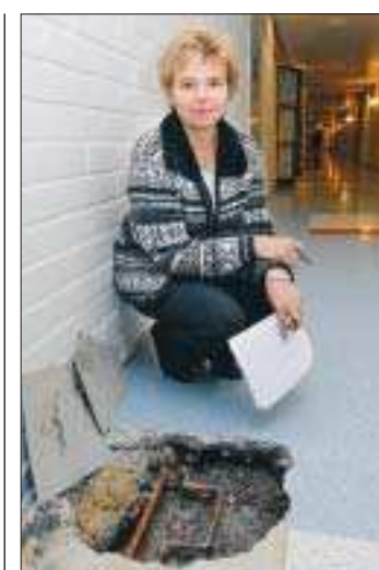
Rektor Jana Ekeboom vid golvet som måste brytas upp på grund av vattenläckan i Ålands yrkesskola.
