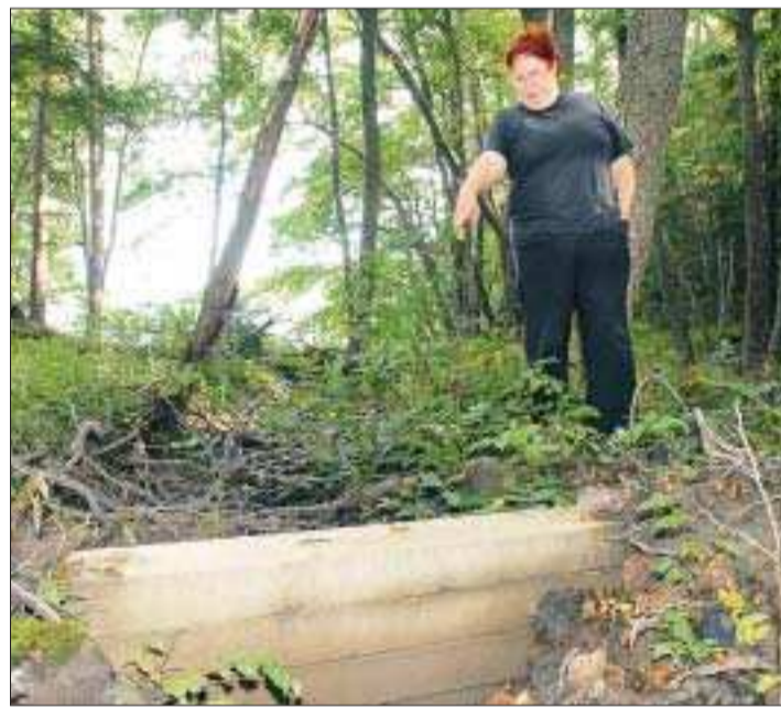
Fungerar inte. Sättdammen – byggd av betongbitar i utfallsdikedet – som ska stänga inne vårflödesvattnet i Borgsjön i Sund fungerar inte, konstaterade landskapets miljöbyrå i mars. Dorita Lindholm visar. Arkivfoto: ERKKI SANTAMALA
