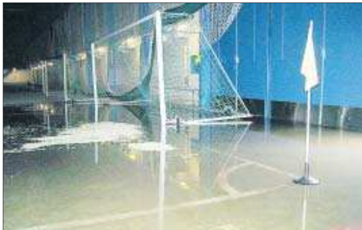
Eckeröhallen översvämmad. Omkring 100 kvadratmeter av konstgräset inne i Eckeröhallen täcktes av vatten i går. Foto: CONDIS
