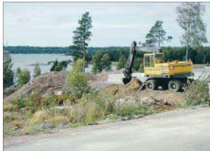
Vid husgrund. Gatan längst nere mot stora vägen har krävt stora mängder sten och jord för att möjliggöra husbyggen. Här fyller Magnus Söderlund ut en tomt med jord.
