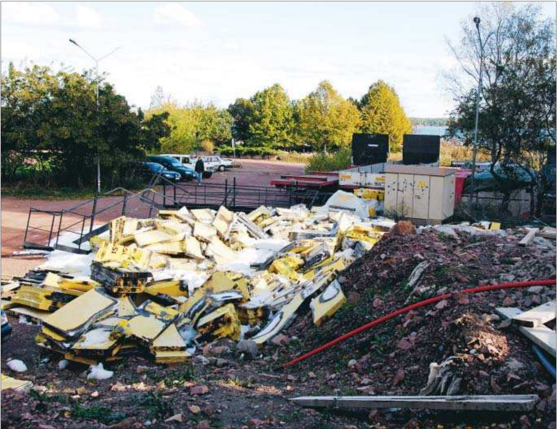
Isolering blev sopor. Så här såg det ut på kk-husets byggplats dagen efter pallbranden.
