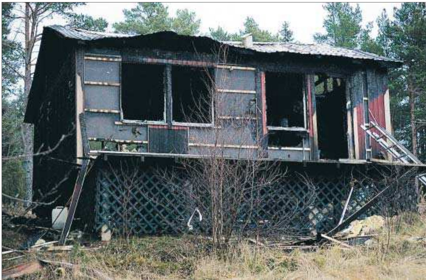
Bara ett sotskelett återstår. Ett plastämbar som stått nära en braskamin misstänks ha orsakat branden i denna stuga i Saltvik Haraldsby, på natten mot torsdagen. Stugan gick inte att rädda. Den var nyligen renoverad och färdigstädades kvällen före.
