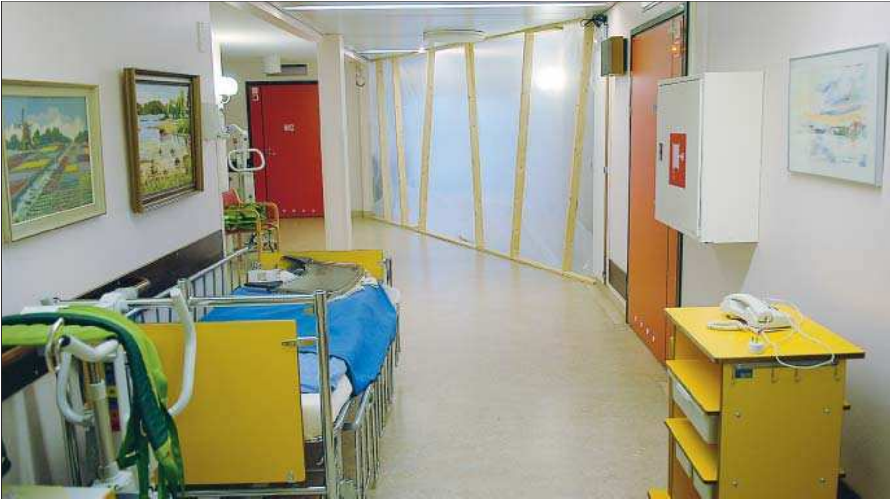
Måste stängas. Bakom plastskynket finns de två patientrum på Övergårds där mögellukten är värst. Statens tekniska forskningsanstalts rapport om vad som bör åtgärdas är nu klar. Arkivfoto: JONAS EDSVIK
