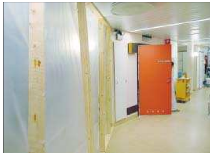
Gullåsen-avdelning. Så här såg det ut på Övergårds i början av november när fuktskadorna konstaterades. Foto: JONAS EDSVIK
