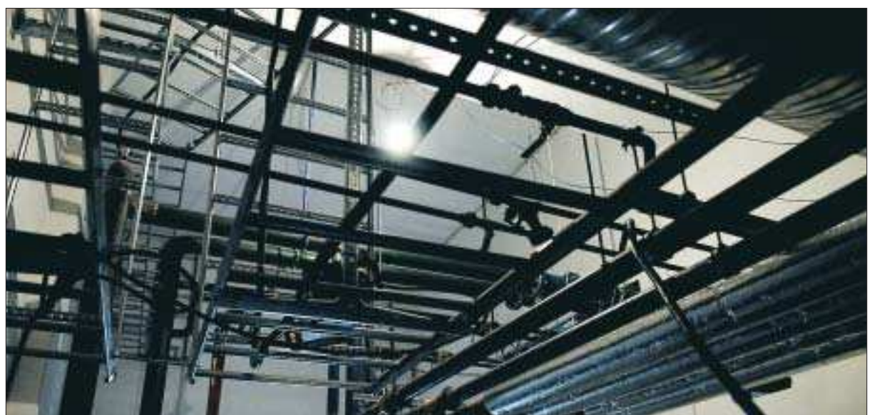
Rör och teknik. I källaren finns också flera teknikrum. Värmen sköts med fjärrvärme och ett rum har tre stora fläktar. – I huset finns hur mycket teknik som helst och många rum får publik och besökare aldrig se, säger Patrik Sundblom.
