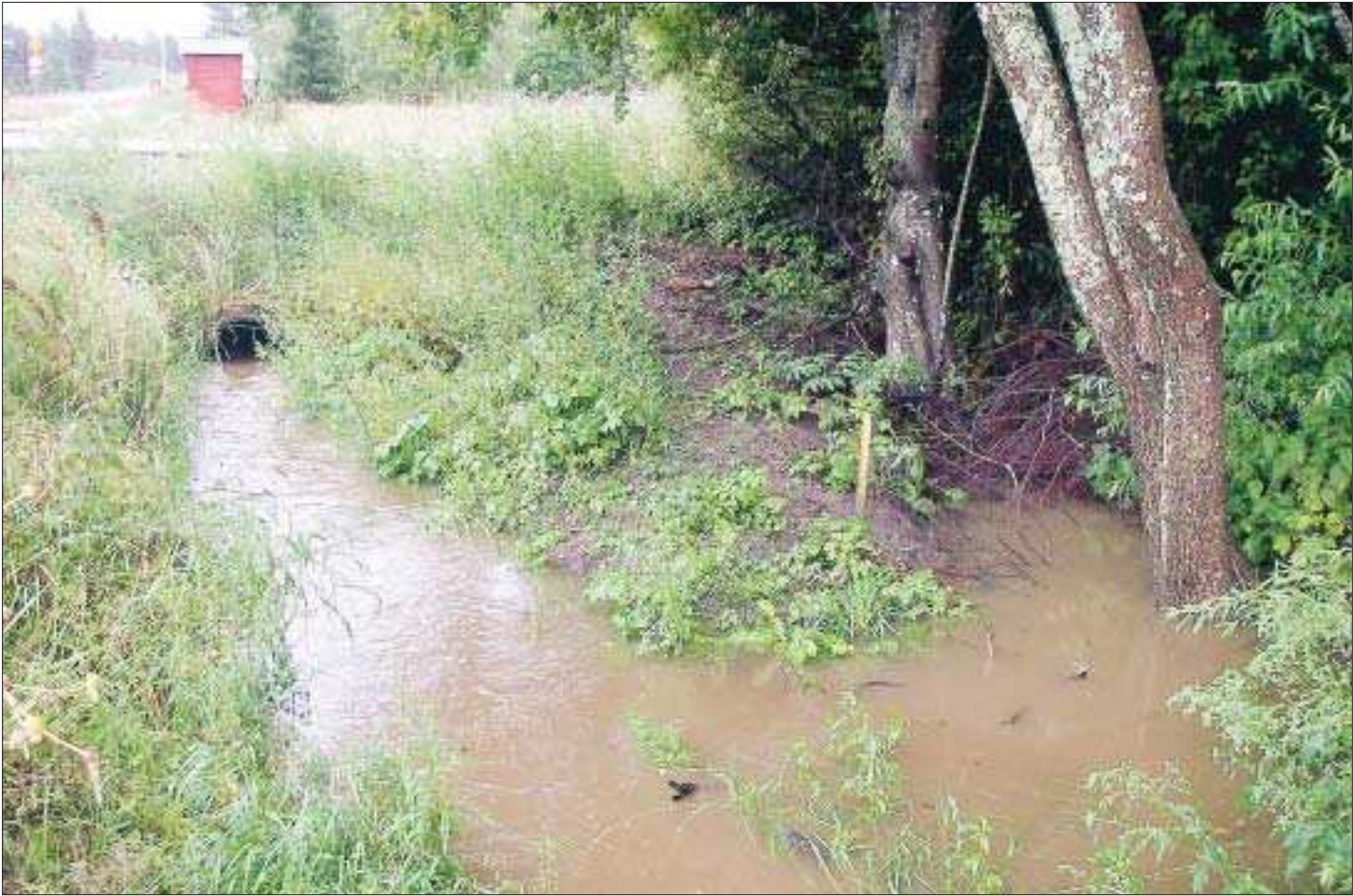
Översvämning igen. Förra året såg det värre ut, men det har onekligen blivit översvämning i Eckerö igen. Sune Mattsson tycker att trumman som lagts in är allför liten, Stig Janson säger att man inte kan bygga utgående från störtregn. Foto: PRIVAT
