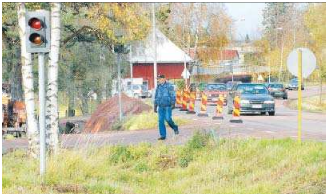
Vattenledning byts. En nästan 50 år gammal vattenledning byts just nu vid västra utfarten i Mariehamn. En betydande mängd vatten, exakt hur stor är okänt, hann läcka ut innan vattenverket upptäckte skadan. Foto: STEFAN ÖHBERG
