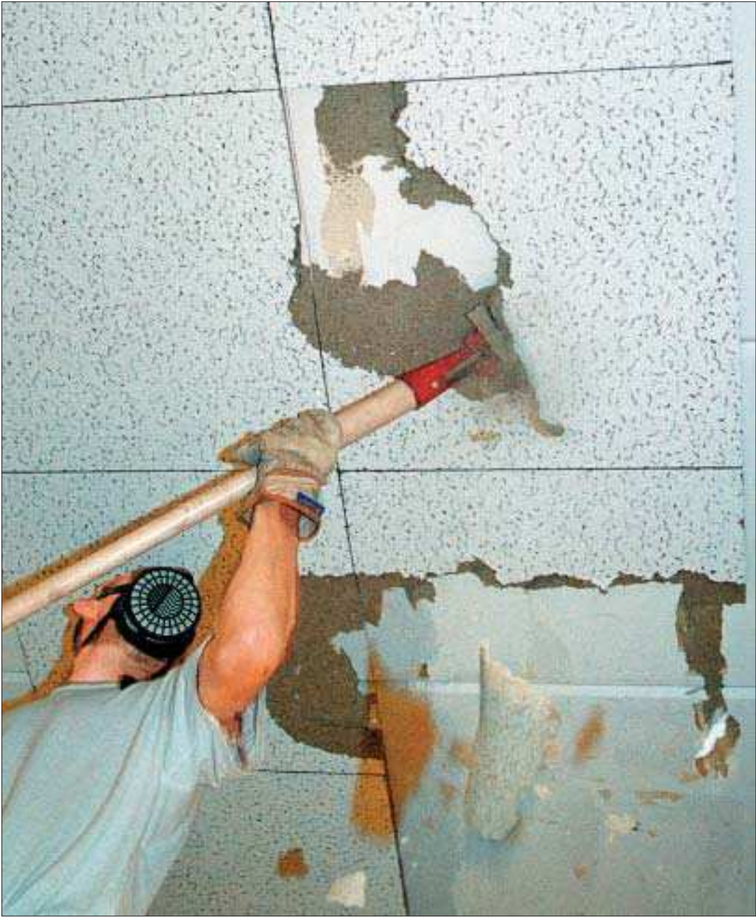
Mögel. Fuktproblemen berör nästan varje finländare, sade bostadsministern i riksdagen på onsdagen. På arkivbilden pågår mögelsanering i Kyrkby högstadieskola. Foto: ERKKI SANTAMALA
