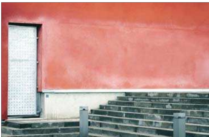
Ångrade sig. Arkitekten ändrade sig och en ny färg målades på. Därför har ojämnheter uppstått. Foto: JAN KRONHOLM
