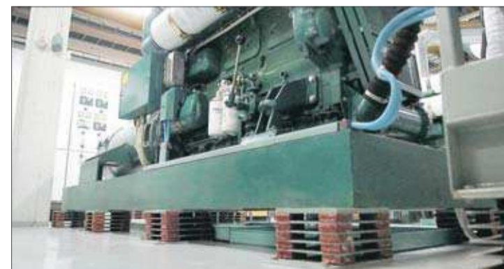
På fjädrar. Inget i Bergsskyddet står rakt på golvet. Dieselgeneratorerna står på fjädrande plattor som skall skydda generatorerna mot vibrationer.
