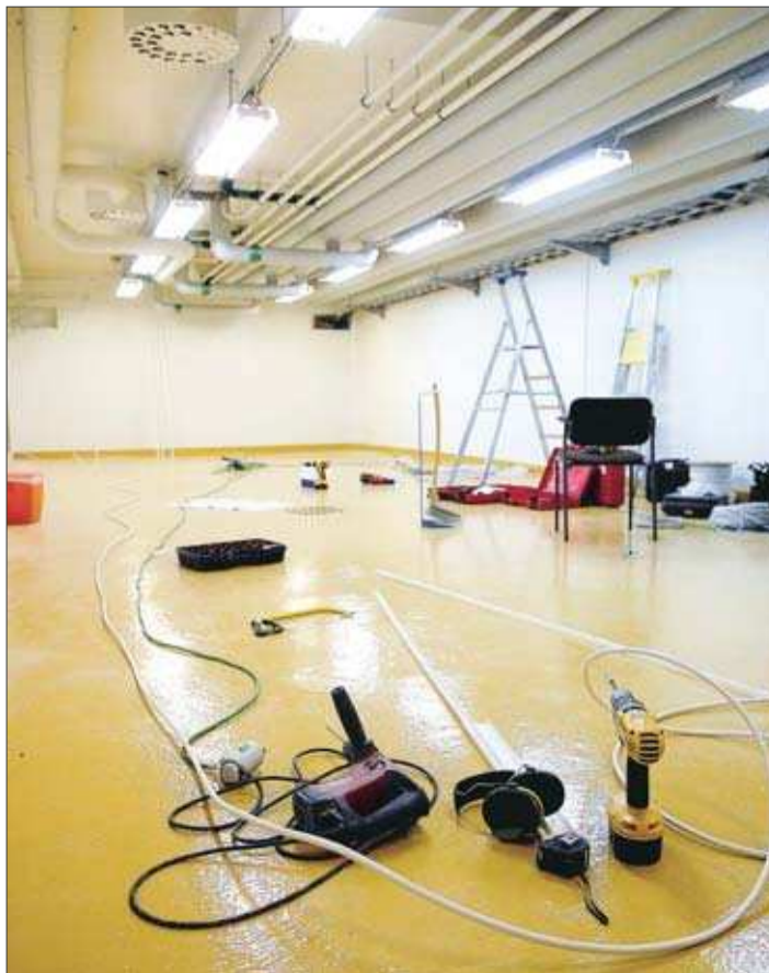
Alandicas skyddsrum. Kultur- och kongresshusets skyddsrum håller som bäst på att iordningställas i Bergsskyddet. Varje person beräknas få 0,75 kvadratmeter att vistas på.
