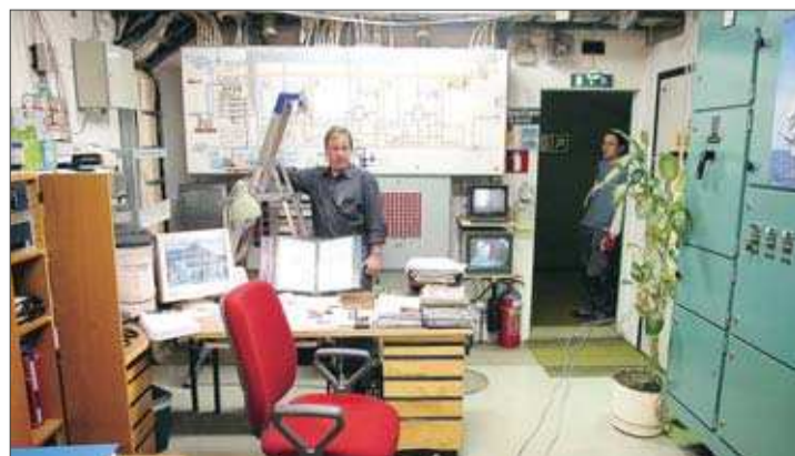
Åtta meter under havsytan. Från sitt rum har Lennart Alexandersson koll på att allt fungerar som det skall i befolkningskyddet.
