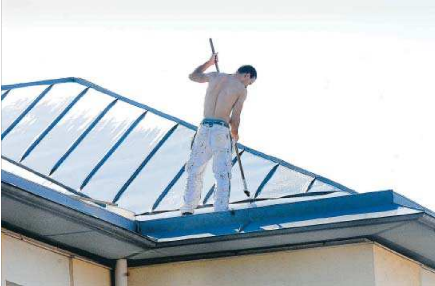
Olagligt 1. Takarbetaren på bilden utför sitt uppdrag på ett olagligt sätt. Det saknas skyddsutrustning som exempelvis arbetssele eller byggnadsställningar. Foto: STEFAN ÖHBERG
