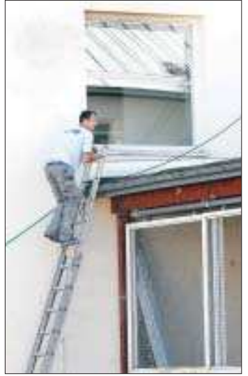
Olagligt 2. Det är också förbjudet att arbeta oskyddad på en stega, säger arbetsskyddsinspektör Henning Karlsson. Foto: STEFAN ÖHBERG
