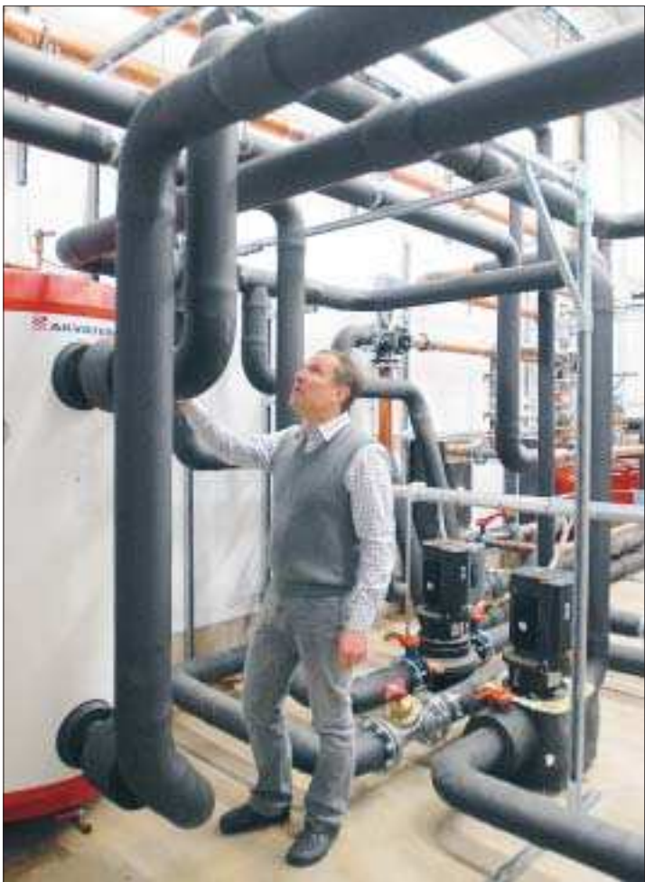
Miljövänligt. Tord Sarling förevisar hur man tar tillvara överskottsvärmen genom bergvärmen och senare återanvänder den genom värmepumpar.
