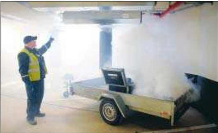
Rökmaskin. Antti Kontkanen använder rökmaskin för att undersöka luftströmmarna och det nya energisnåla fläktsystemet i Miramargaraget.
