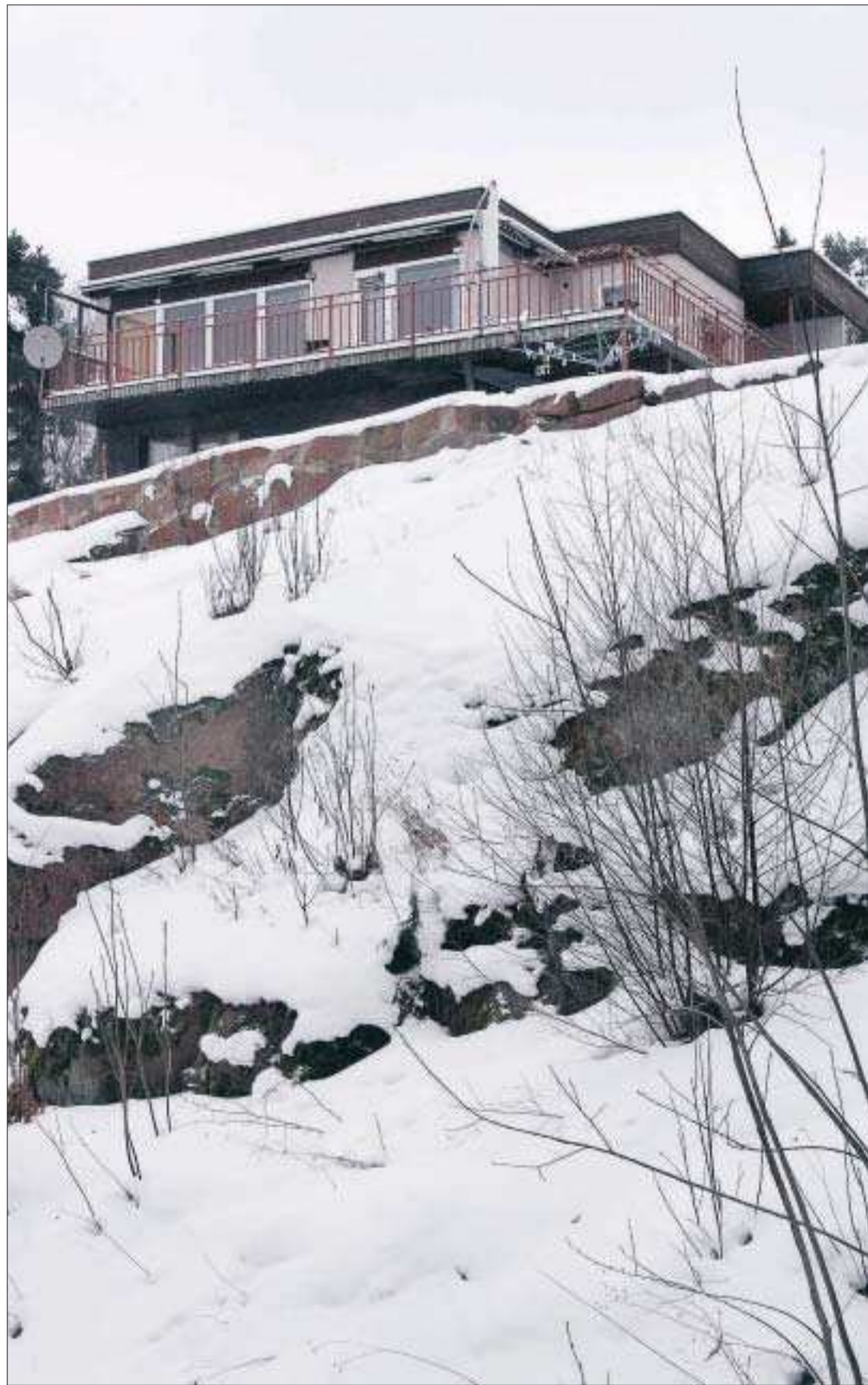
På berget. Tvisten handlar om huset, byggt delvis på berget, som enligt ägarna skakade så kraftigt vid en sprängning drygt 100 meter bort att väggarna sprack. Sprängföretaget nekar till skuld. Foto: STEFAN ÖHBERG
