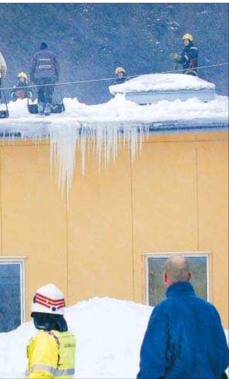
skottade snön av Optimovas tak, för att hindra att det kollapsade.
