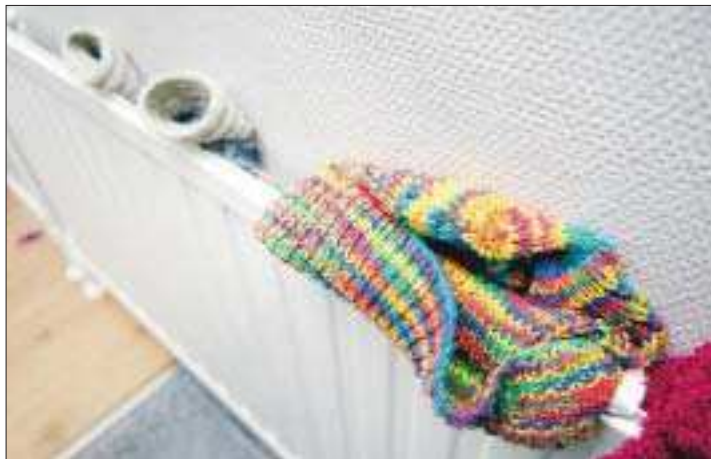
Ingen golvvärme. Radiator, batteri, vad man än kallar det så finns det ännu sådana kvar i huset.
